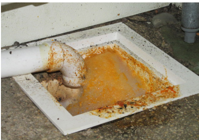
El exceso de grasa entrando por el drenaje en el piso del fregadero para lavar platos. Utilizando las mejores prácticas de gestión en su cocina puede ayudar a evitar la sobrecarga de la trampa de grasa.
