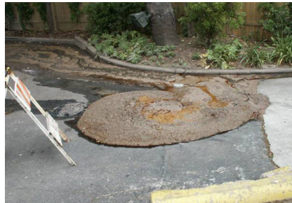
Un desbordamiento de una trampa de grasa en el estacionamiento de un establecimiento de servicio de alimentos.
