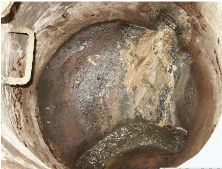
Grasa que fluye hacia el alcantarillado sanitario de una línea de servicio de un establecimiento de servicio de alimentos.
